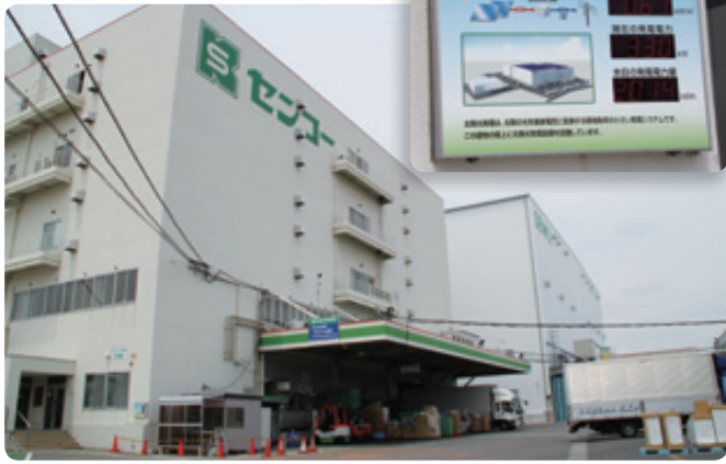
小牧支店の屋上の約1,000坪のスペースに設置されている太陽光発電システム。外壁には、発電状況が一目でわかる掲示板が設置されている
