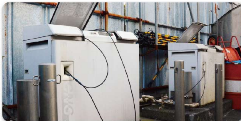
← 自社敷地内に設置されている 2基の小型充填機
