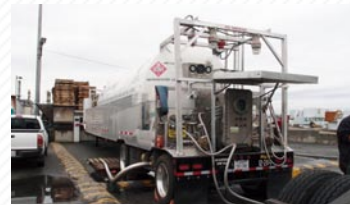
図7 移動式LNG充填設備：タンク容量は6,000ガロン。1日に10台程度のLNGトラックが充填を行う。
